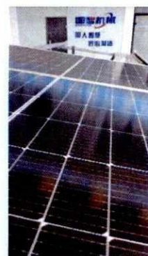
Fig. 69. Panouri fotovoltaice în interiorul unei clădiri; în fundal, inscripția „国智机械” (GUOZHIXIE)
